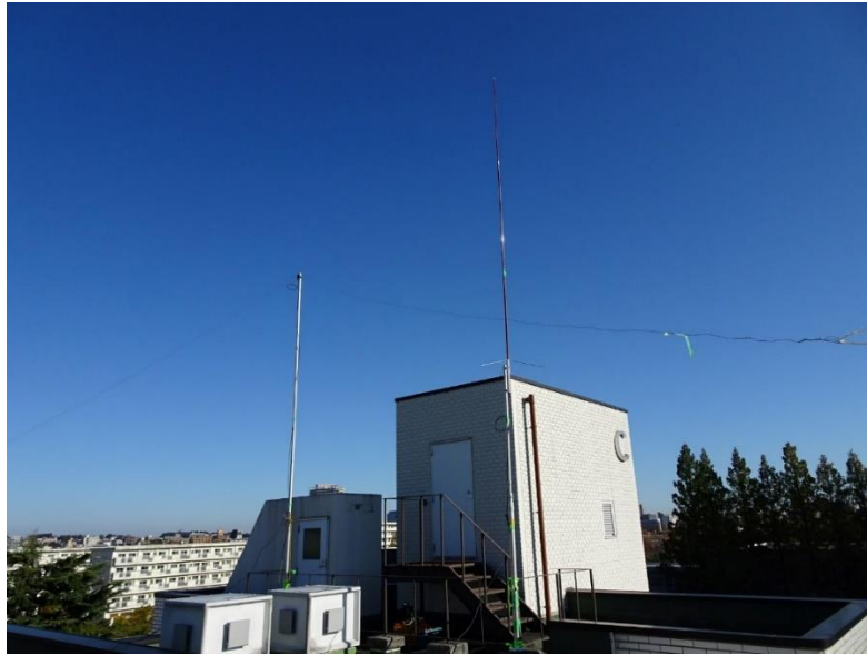
図 7 学祭において講義棟の屋上に設置したアンテナの様子
